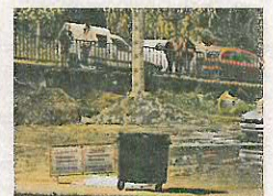
El hombre cayó en una zona en obras. SANTI M. AMIL
